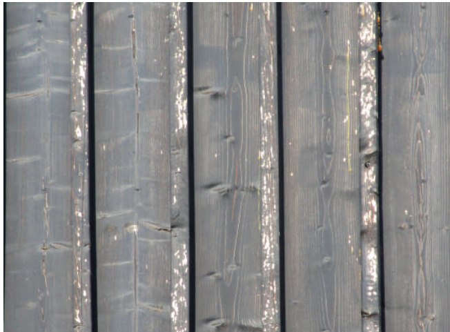
Holzschalung mit typischem Wespenfrass.
