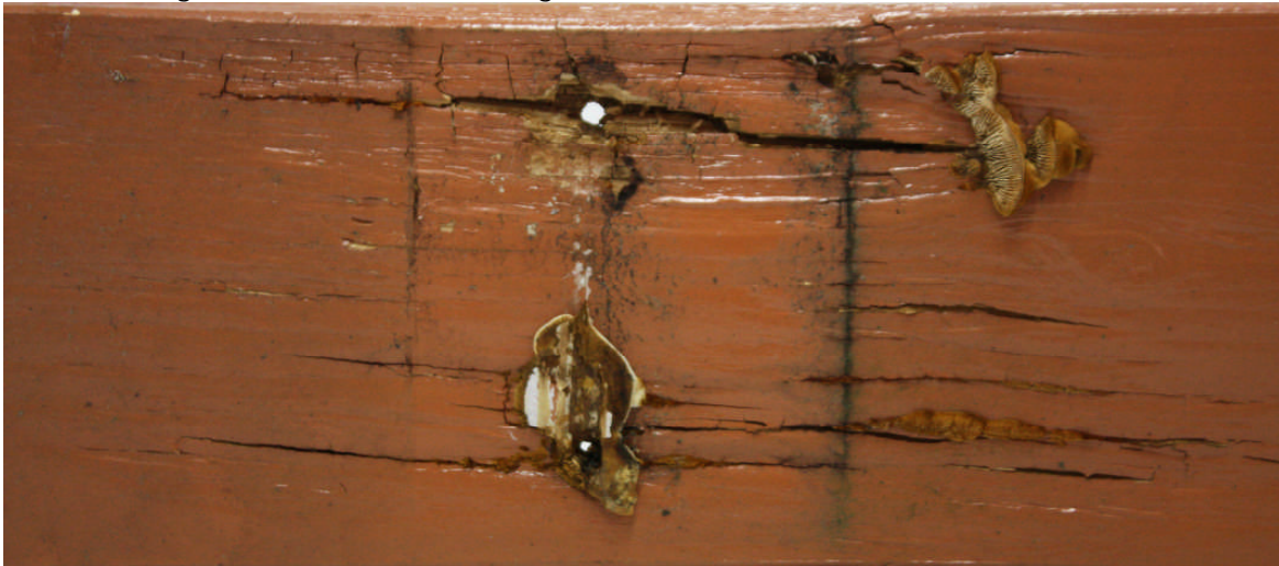
Beschichtung ohne Holzschutzgrundierung. Zerstörung durch Blätling.
