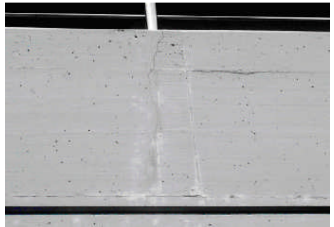
Ausblühungen an Balkonen, ausgehend von Rissen und Brauen.
