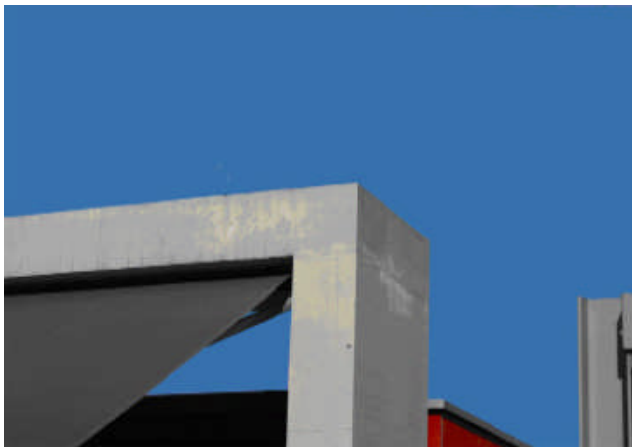
Konstruktives Problem: Betonelemente, Wasser dringt von oben durch Brauen in den Beton ein.
