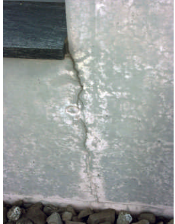
Betonwand, Wasser dringt von unten und über die Rissflanken in den Beton ein. Die Schichtdicke des Anstrichs liegt unter 20 µm.
