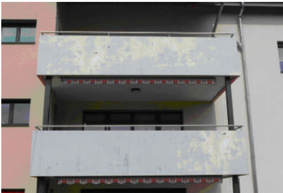
Vorgefertigte Betonelemente mit Fassadenfarbenbeschichtung. Ausblühungen im Rissbereich.
